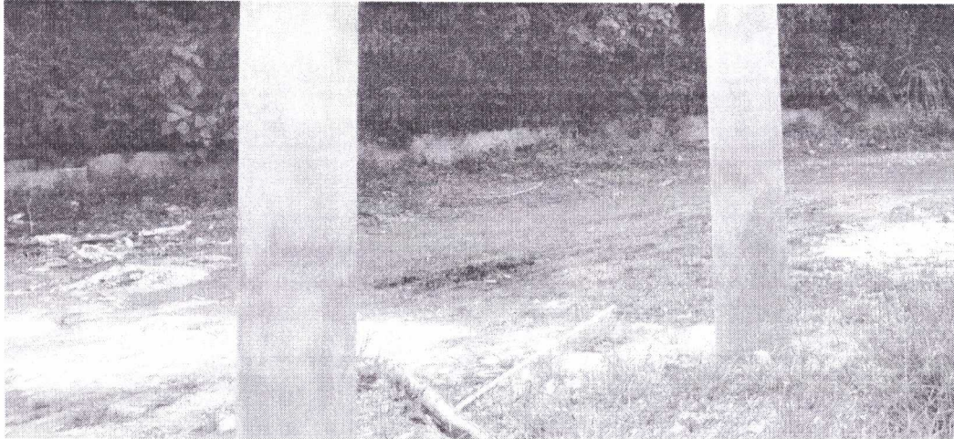
Im 19 – Piso externo danificado pela passagem de maquinário para a obra.
